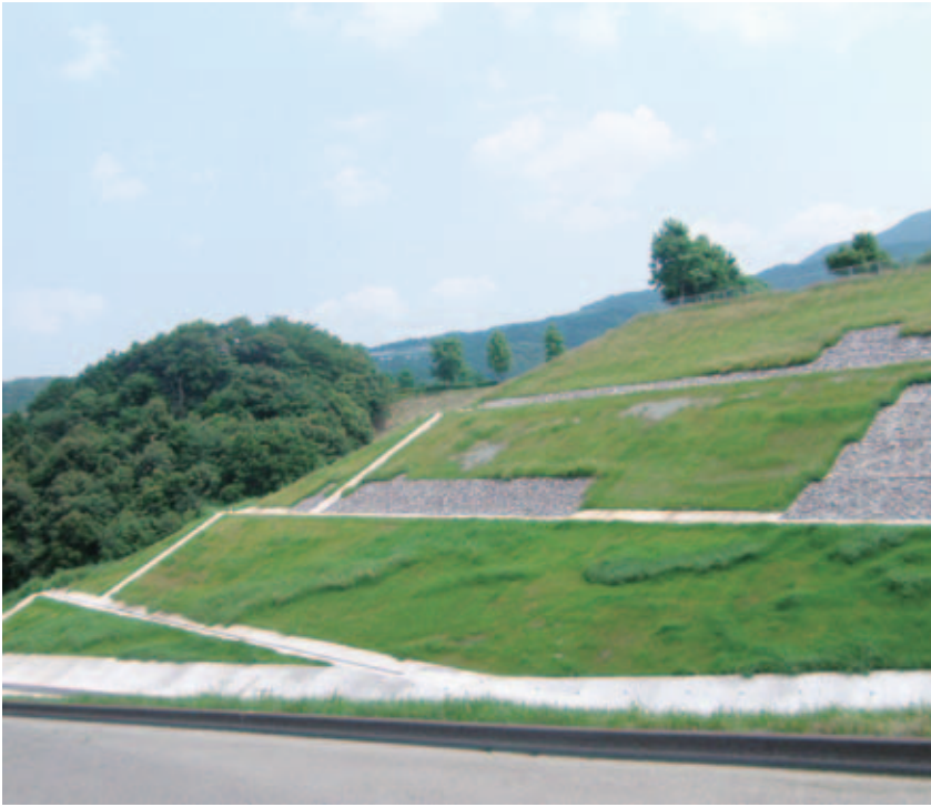
巖木地域開発道路整備事業市道岩の元線改良工事(その1)(佐賀県)
